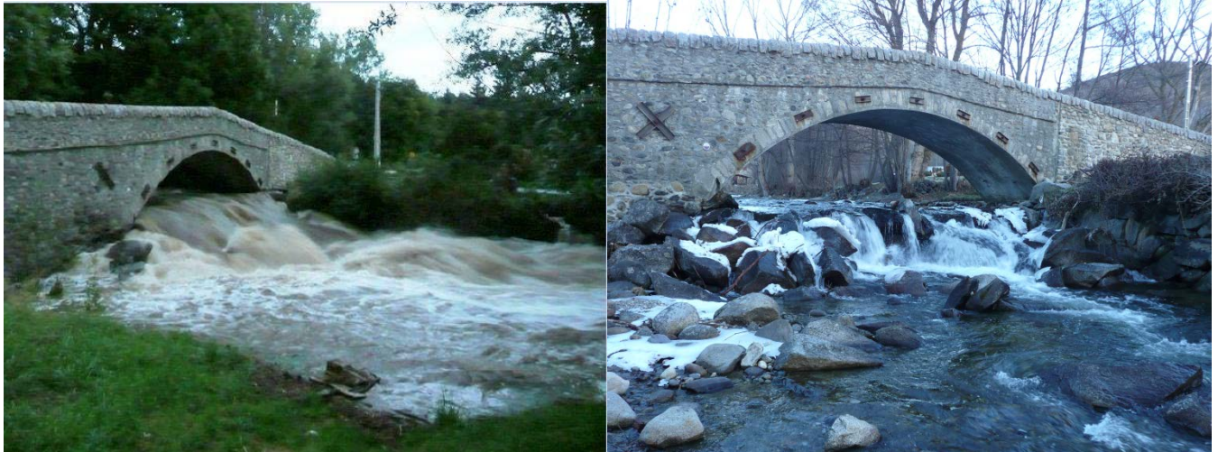
Crue du 07 09 2014 Vue de la brèche dans la rasclosa (janvier 2015)
